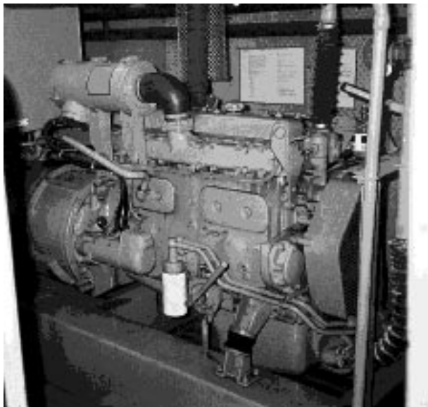
Kraftaggregat batteri Ellenabben, Bollö
